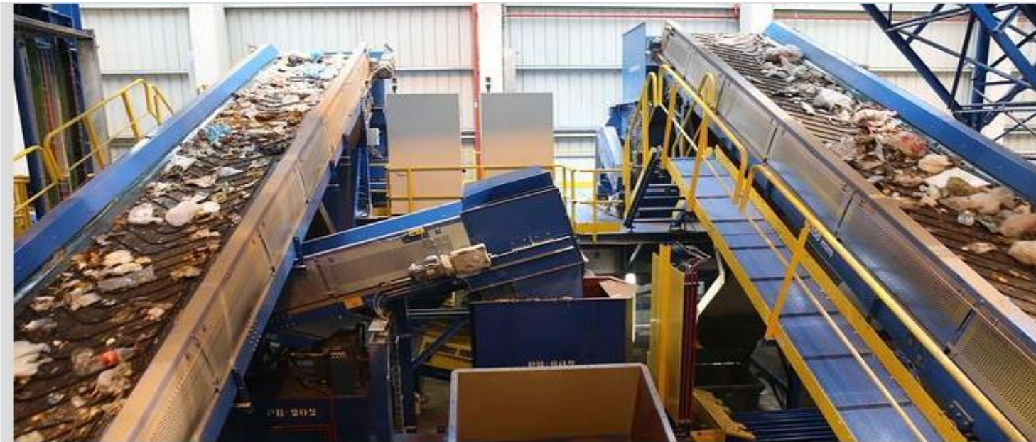
Vista de la planta de tratamiento mecánico biológico de residuos de Arraiz./ Luis Ángel Gómez
